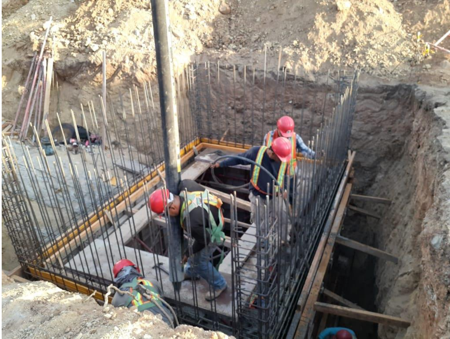
Cisterna de reusó
